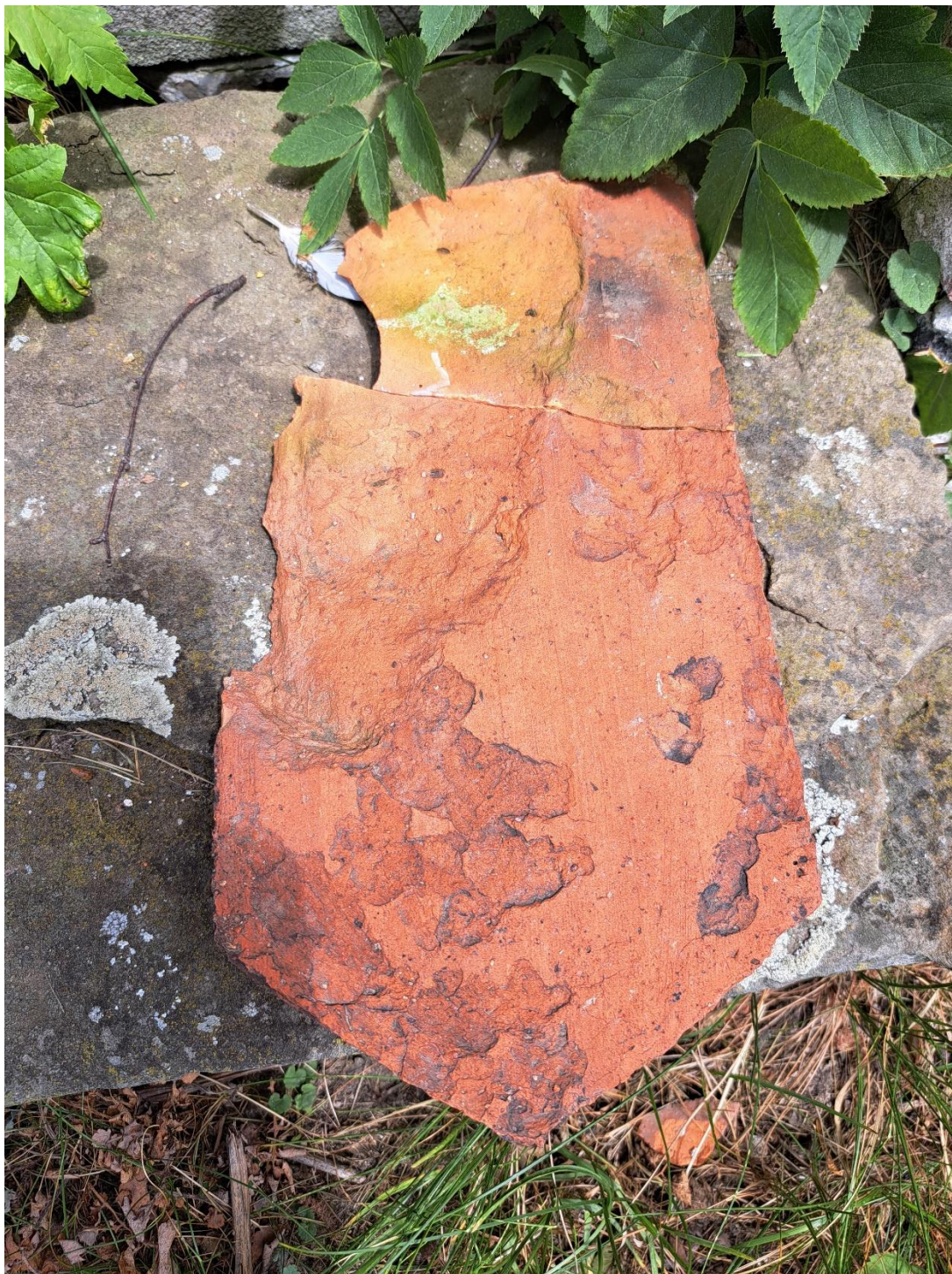
Dachówka znaleziona przy wejściu na elewacji południowej, najprawdopodobniej element oryginalnego pokrycia dachu.
