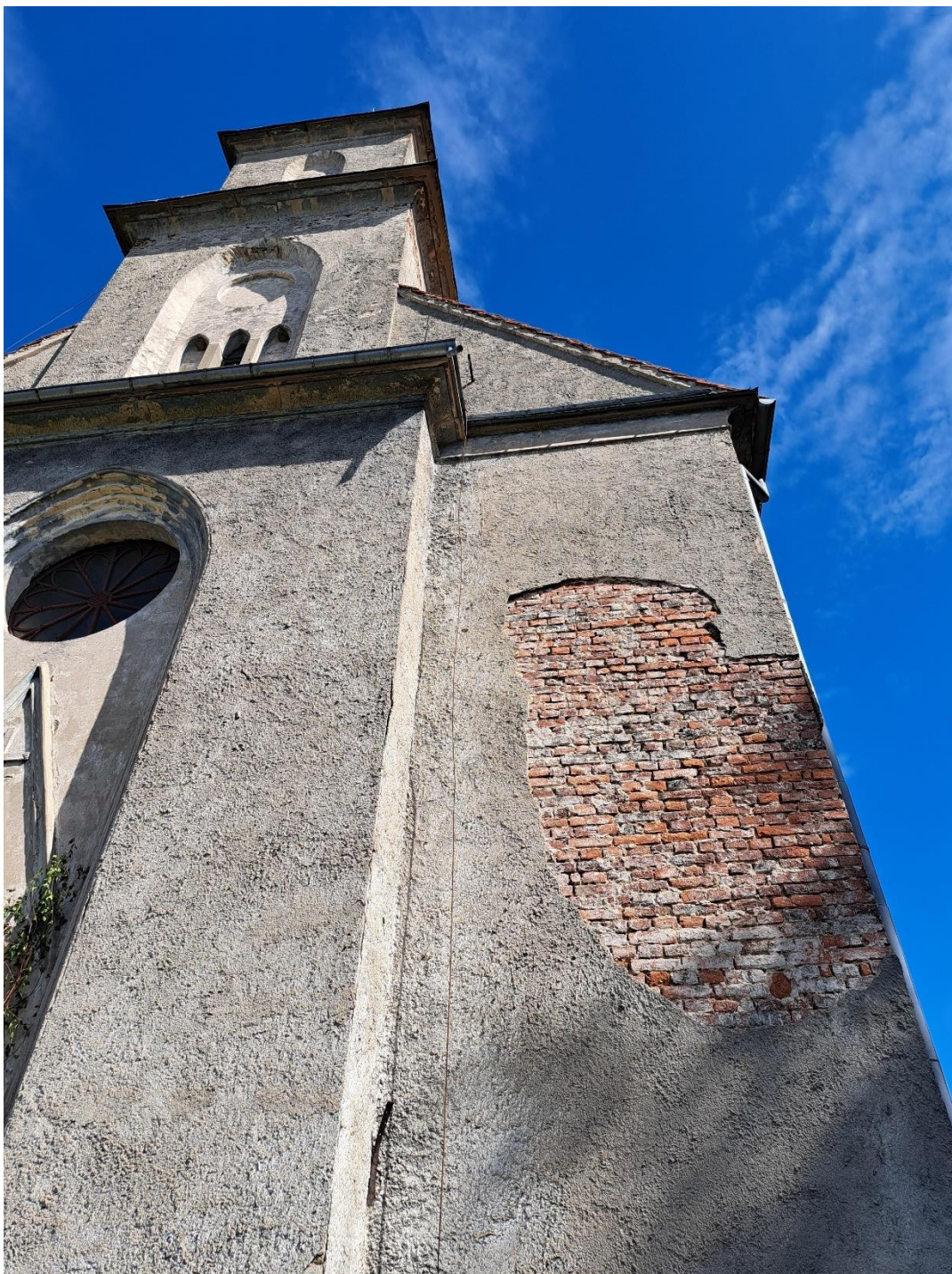
Fragment elewacji zachodniej – obecny stan zachowania. Widoczne na wtórne warstwy tynku fakturalnego oraz ubytki i zabrudzenia powierzchni elewacji.
