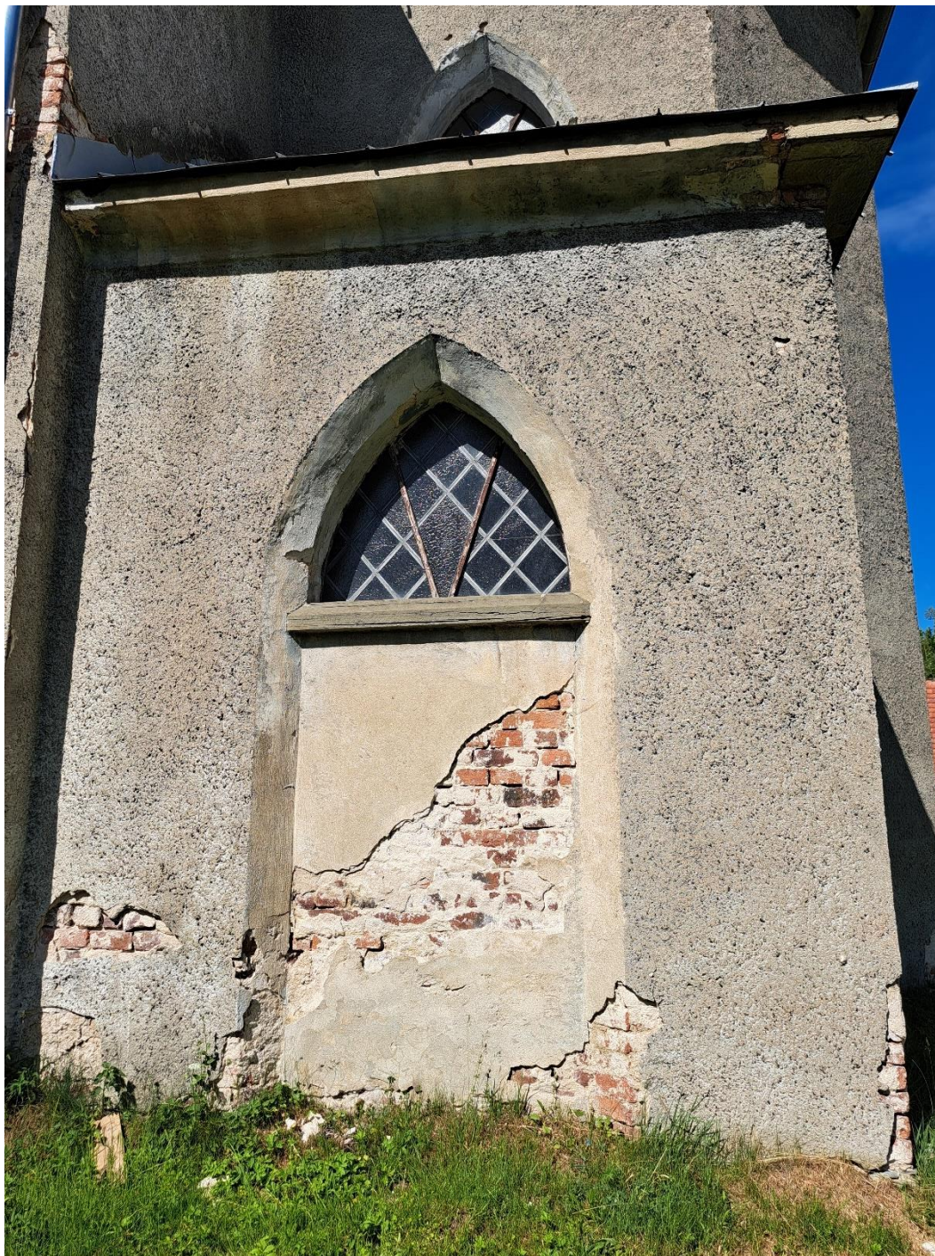
Fragment elewacji południowej – południowa ściana prezbiterium. Przykład stanu zachowania obiektu. Widoczne znaczne zniszczenia wypraw tynkarskich i powłok malarskich, w tym zabrudzenia, ubytki i odstąpięty, zerodowany ceglany mur, jak również stan zachowania okna w formie naświetla.
