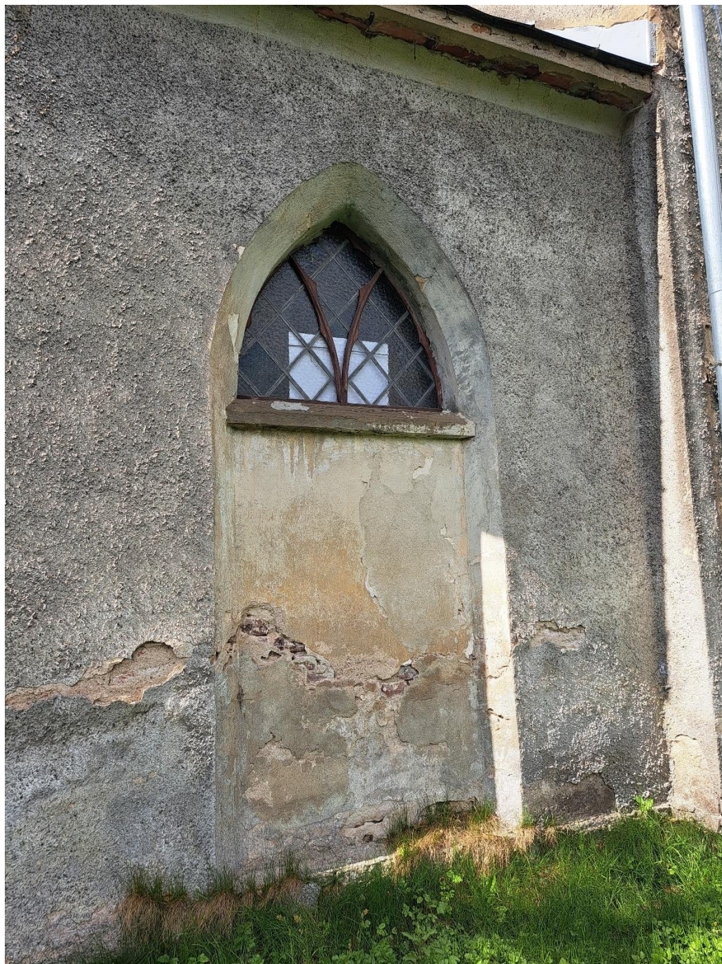
Fragment elewacji północnej, ściana prezbiterium - przykład stanu zachowania obiektu. Widoczne znaczne zniszczenia wypraw tynkarskich i powłok malarskich, w tym zabrudzenia, ubytki i odstąpięty, zerodowany ceglany mur, jak również stan zachowania okna w formie naświetla.
