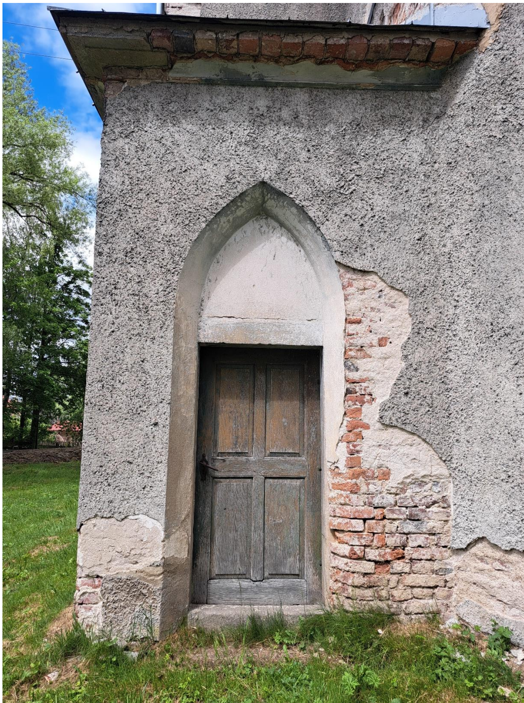
Wejście na elewacji wschodniej – obecny stan zachowania stolarki drzwiowej i elewacji wokół wejścia.
