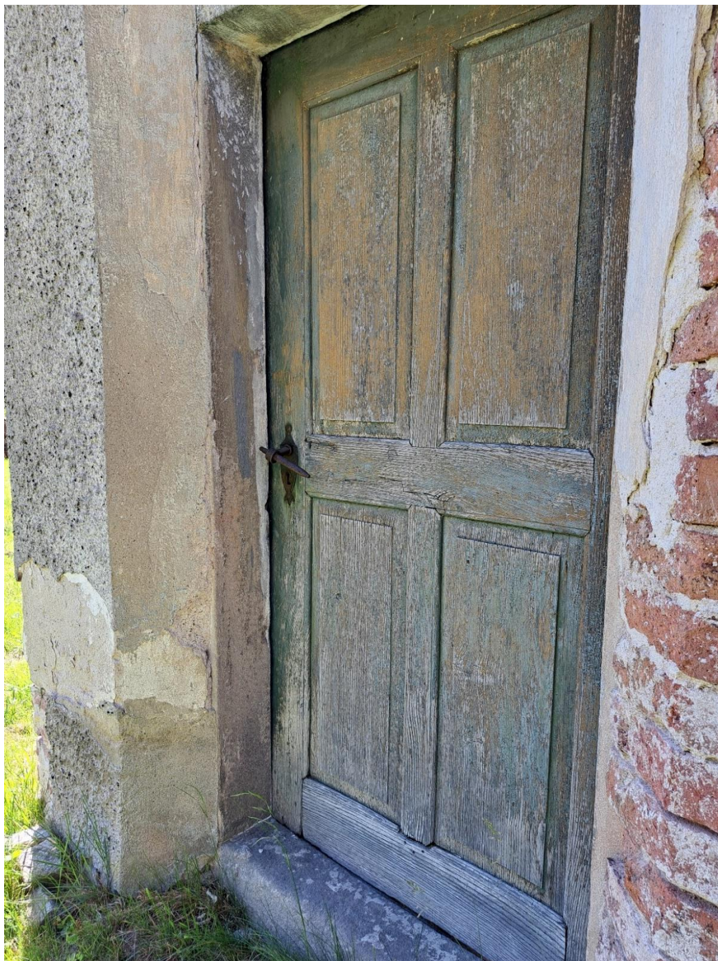
Wejście na elewacji wschodniej – obecny stan zachowania stolarki drzwiowej
