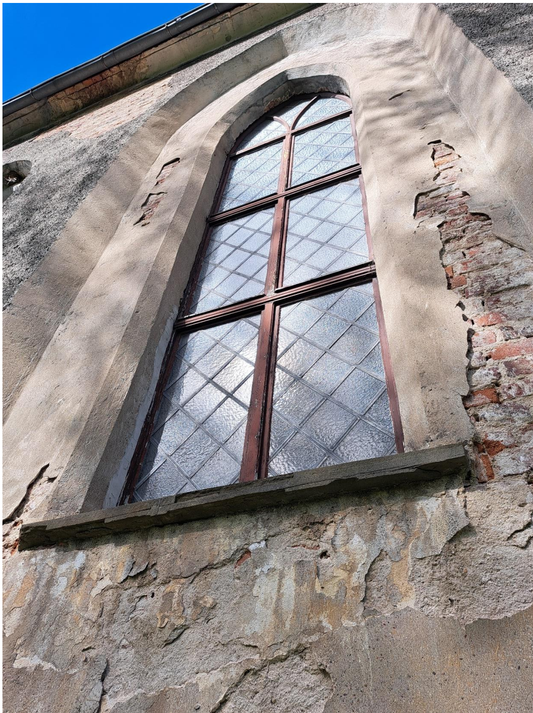
Fragment elewacji południowej – przykład stanu zachowania obiektu. Widoczne znaczne zniszczenia wypraw tynkarskich i powłok malarskich rozwarstwienia i zabrudzenia piaskowcowych parapetów.
