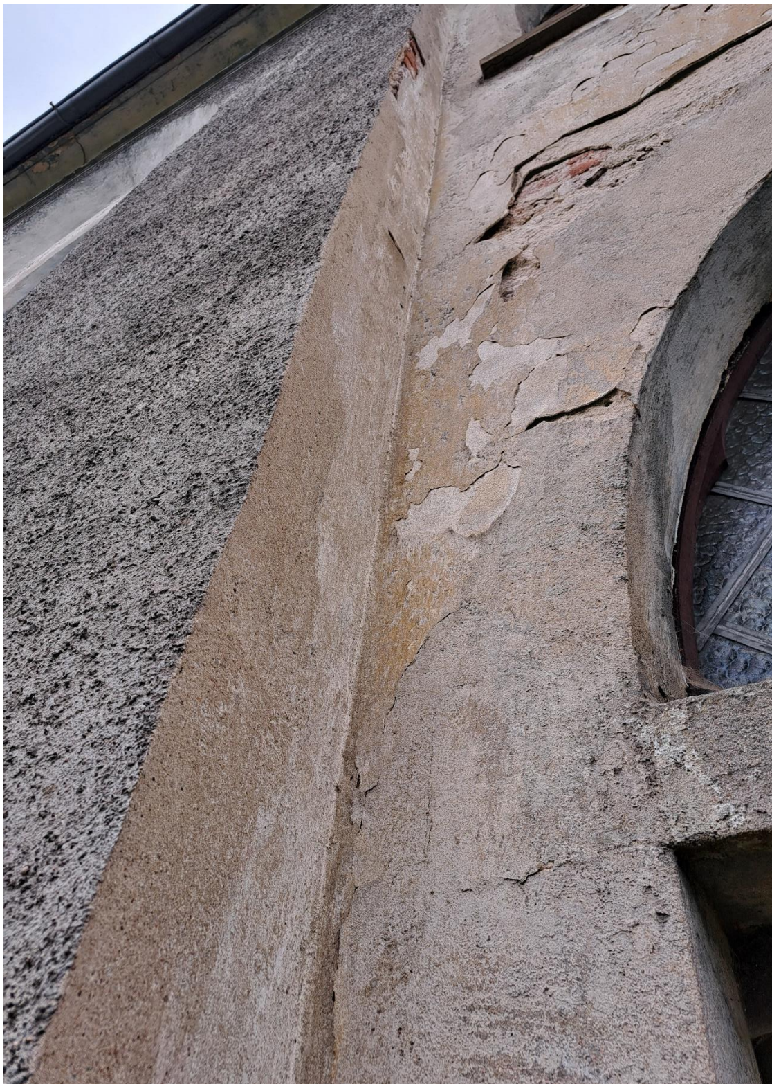
Fragment elewacji północnej – przykład stanu zachowania obiektu. Widoczne znaczne zniszczenia - łuszcząca się zerodowana powierzchnia tynków i warstw malarskich.
