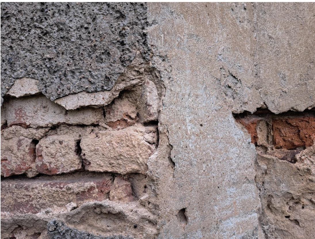
Fragmenty elewacji kościoła - przykład stanu zachowania obiektu. Widoczne znaczne zniszczenia wypraw tynkarskich i powłok malarskich, w tym zabrudzenia, ubytki i odstąpięty, zerodowany ceglany mur.
